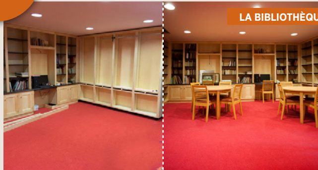
Finalisation des travaux dans la bibliothèque : nouveaux meubles, nouveaux linéaires et deux postes informatiques
